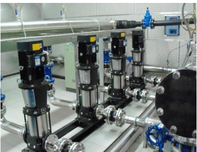
二次供水设施
